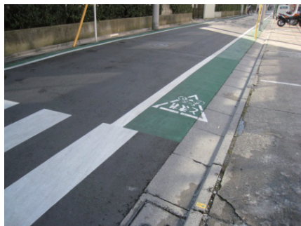
写真２５ 車道と歩道の間の段差での転倒が２９件
